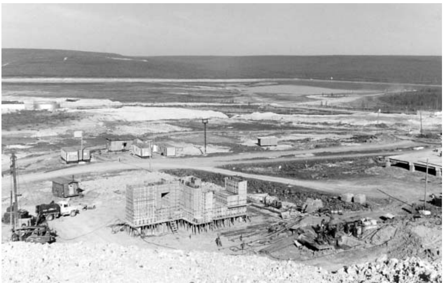
Вид на хвостохранилище фабрики №8 АГОКа. На переднем плане – строится вертикальный ствол рудника "Айхал"
